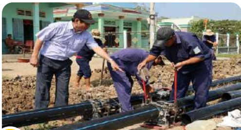
01 Cấp nước sinh hoạt H. Hiệp Hòa, Bắc Giang
